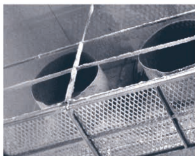
Formation de glace sur les appareils et les équipements, obstruant les conduits d'aération
