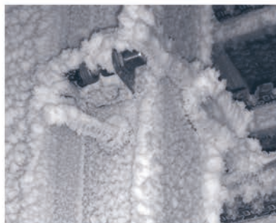
Accumulation d'eau et de glace sur la structure des bâtiments
