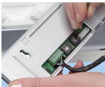
Le réglage des débits d'air sont réalisés par l'installateur grâce aux potentiomètres situés à l'arrière du panneau de commande
